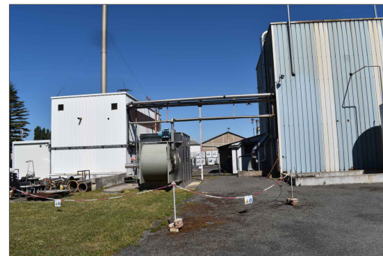
Nouvelle tour aéroréfrigérante identique à l' existante (machinerie)
